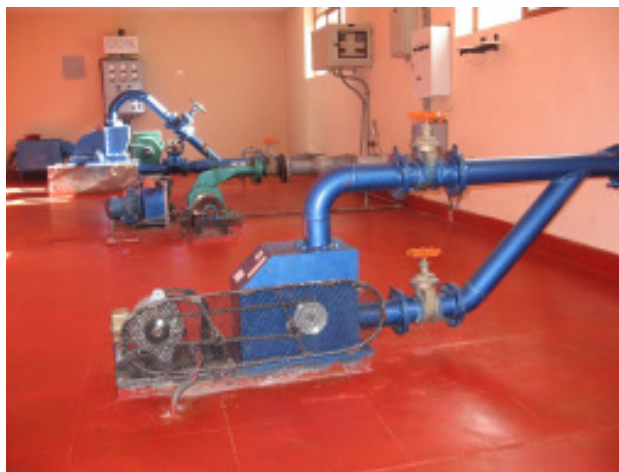
Schulungszentrum für Wasserkraftanlagen (Foto: Garbers)
